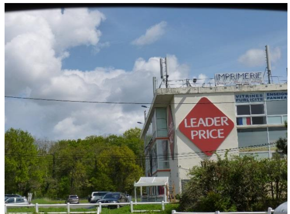
Enseigne installée en toiture terrasse
